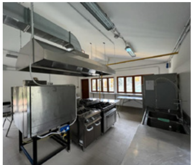
In questa foto e a destra: le nuove attrezzature installate nella cucina del Parco della Pace
